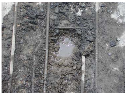
写真-4 床版内の滞水状況
