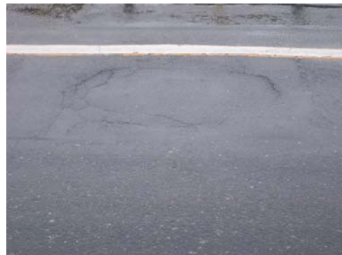
写真-1 舗装路面の変状
